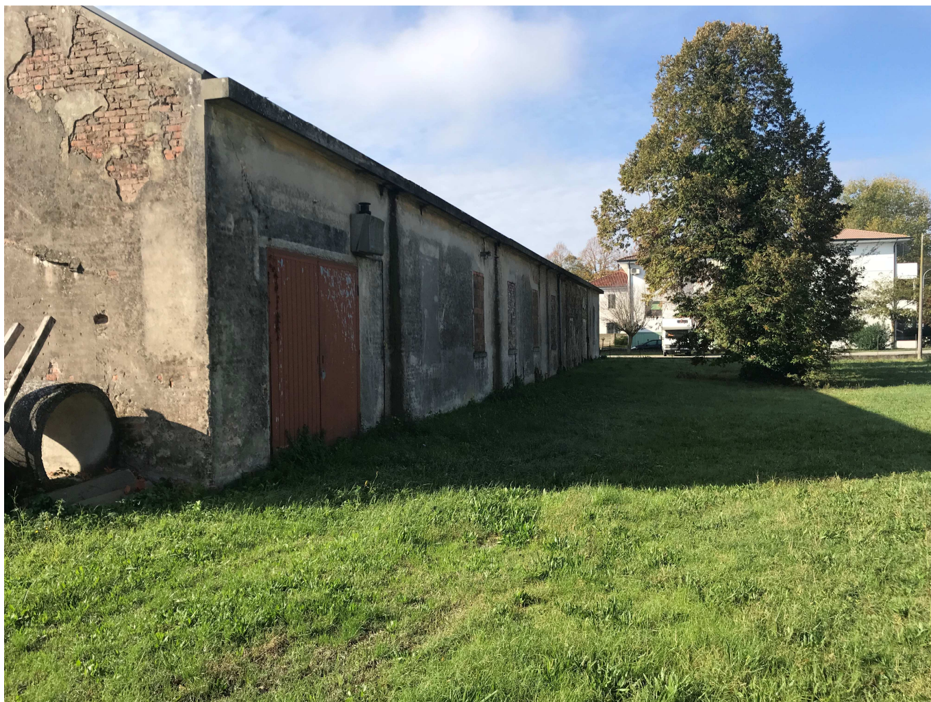
VEDUTA DELLA PARTE ANTERIORE DELL'AREA E DEL FABBRICATO - LATO NORD SU FRONTE STRADA
